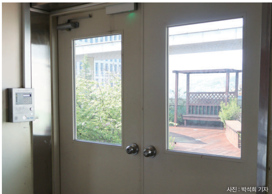
▲비상문자동개폐장치로 인해 닫혀있는 창의관 옥상 휴게 공원 출입문
